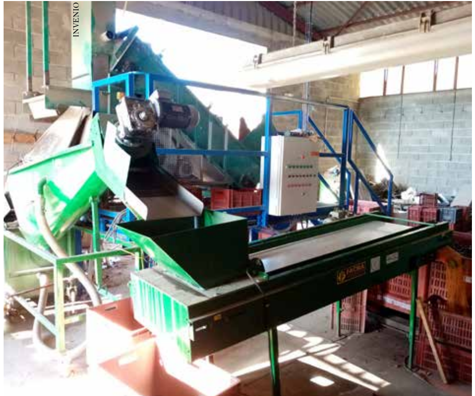
Aménagements 2023 sur la ligne de conditionnement : système d'épierrage, bac de trempage, tapis de tri à débit régulé pour une optimisation de la qualité des lots. Deux opérateurs suffisent à la gestion de flux grâce à ces améliorations !
